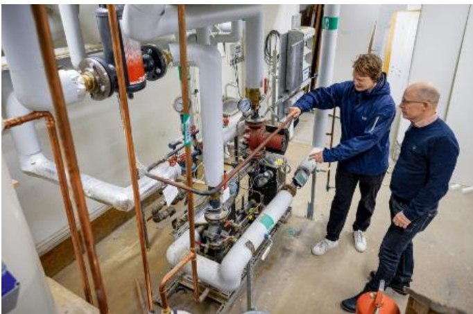
Bild 2: Das Retrofit-Projekt in der Gyllenstiernsgatan war erst der Anfang: Stockholm Exergi und ebm-papst planen, weitere Gebäude in Stockholm energieeffizienter zu gestalten.
